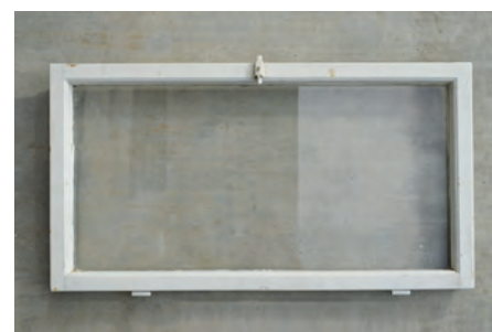
Obr. 7i: Rám vnitřního křídla ventilačního okna z interiéru se závěsy umístěnými na dolní části rámu. Na rámu křídla je dochována zástrčka pro zajištění okna do protikusu – okenní skoby na rámu okna. (foto M. Klačka a J. Hanžl)
