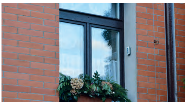
Obr. 10: Repasované okno z doby působení fy Soit s nevhodnou poutčovou úpravou. (foto M. Šolc)
