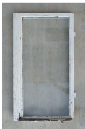
Obr. 7e: Rám venkovního křídla z exteriéru s dochovanou dřevěnou okapničkou a klapačkou. (foto M. Klačka a J. Hanžl)
