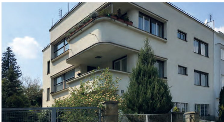
Pohled na průčelí brněnské funkcionalistické vily maďarského architekta Emericha Spitzera před rekonstrukcí. Okna byla v 3. podlaží neodborně doplněna o dvojsklo za původní jednoduché zasklení. (foto G. Kurtis)
