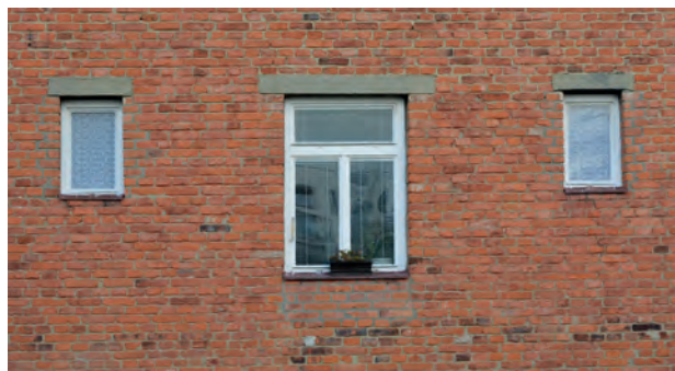
Obr. 8: Výměna výplně okenního otvoru v průběhu působení fy Soit ve Zlíně. Zachovává podstatnou část autentických prvků původního okna. Změna je ve větší šířce profilu materiálu pro výrobu rámu okna a ve způsobu otevírání světlíku. Z dnešního pohledu se jedná o dobovou tvarovou analogii. (foto M. Šolc)
